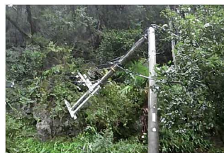
電柱等の被災
