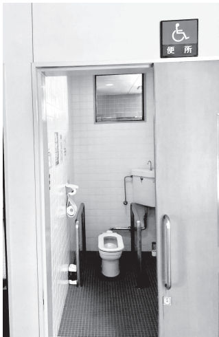
中央公民館3階 洋式トイレの現状
