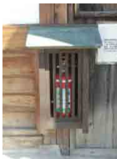
屋外消火器の設置 (今井町)
