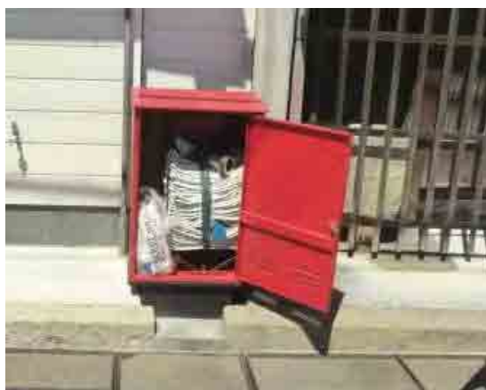
ホース等格納箱 (新町通り)
