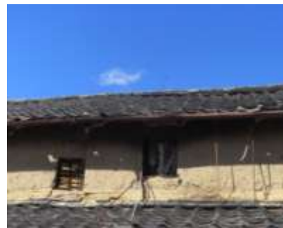
塗り込めが傷んでいる状況
