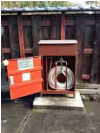
2号消火栓 (五個荘地区)
