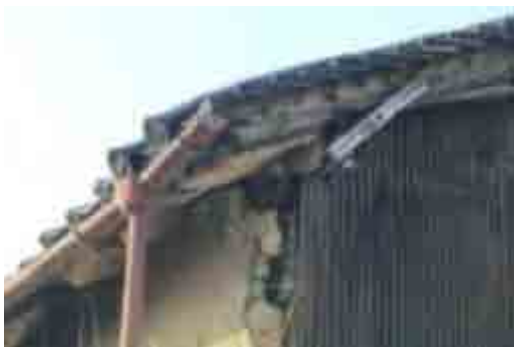
傷んだ漆喰・大壁
