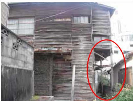
柱の数箇所に破損がある例（50点）
