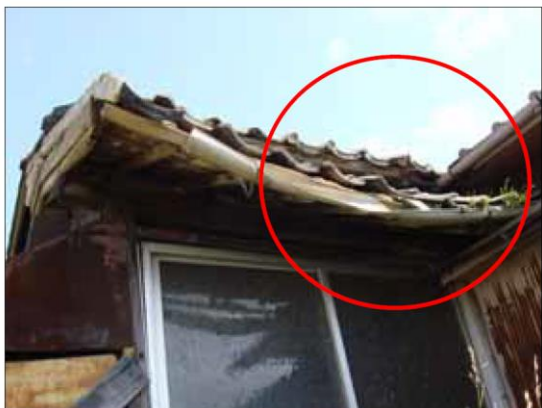
軒の裏板、たる木等が腐朽し、軒が垂れ下がっている例(25点)
