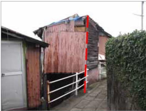
一部の柱が傾斜している例（25点）
