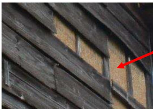
事例) 仕上材(木板)の剥離(部分的)により、外壁の下地露出(評点15)
