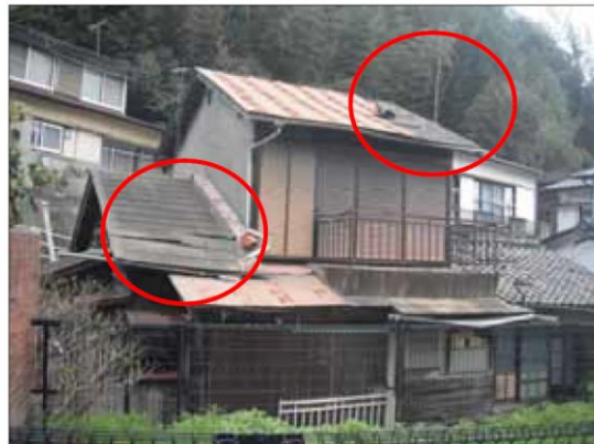
アスファルト屋根等の一部にズレがあり、雨漏りのある例(15点)
