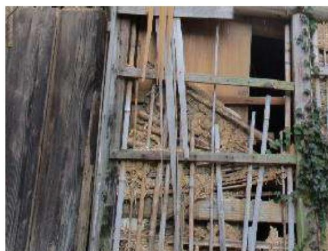
事例) 壁体を貫通する穴を生じている(評点25)
