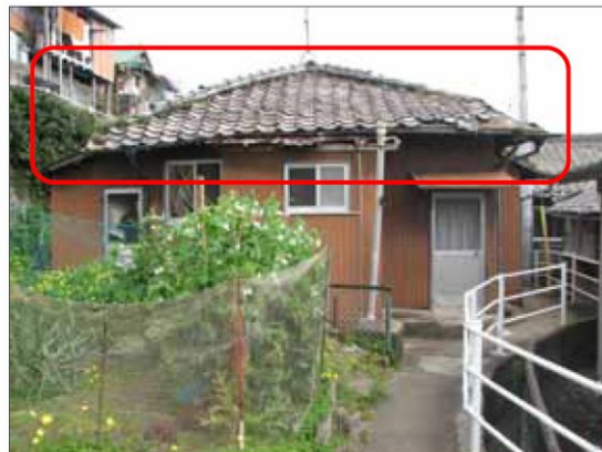
屋根に不陸がある例(50点)
