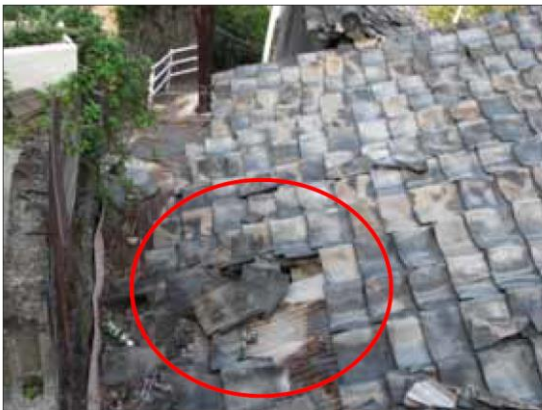
瓦の一部に剥離とズレがあり、雨漏りのある例(15点)
