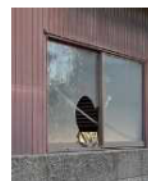
窓が割れた 管理不全空家
