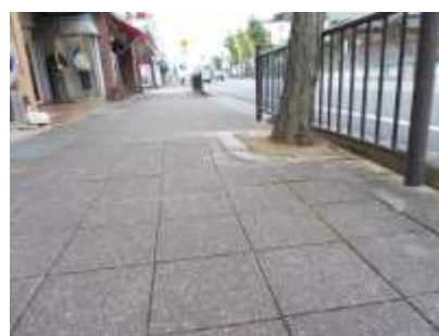
(2) 植樹の根張りによる舗装の隆起
