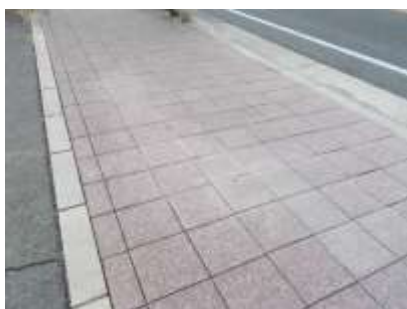
(1) 平板ブロック舗装の浮き
