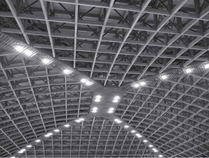
屋根を形成する県産の集成材を内装として見せる構造が特徴
