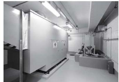
地下の自家発電設備
