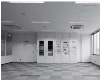
2階の通信指令室
