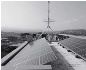
屋上にはソーラーパネルを設置
